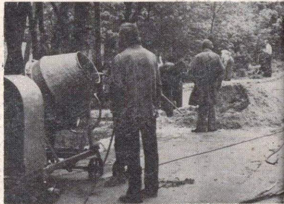
Młodzież z działu głównego mechanika wykonała betonową alejkę między halami jedynką i dwójką. 16 osób pracowało do chwili zakończenia zadania tj. do godziny 12.30
