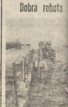
Zakończono budowę parkingu przy wejściem głównym do WSK (pozostało tylko położenie asfaltowego „wanu”). Tym razem brigada budowlana pod wodzą mistrza Mariana Ładzika przystąpiła do budowy kolejnego. Usytuowany został w sąsiedztwie budynku szkolenia.
